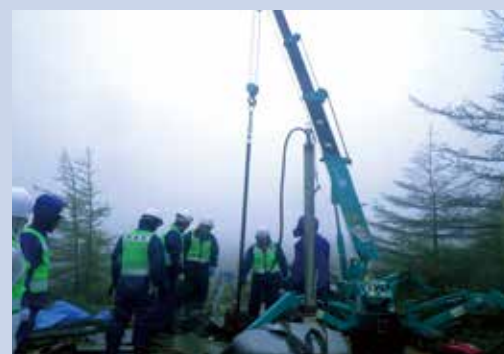
南観測点（湯釜火口の南500m）、地下120mに設置された傾斜計センサ（写真中央、ケーブルが接続された縦長の装置）の交換作業。
