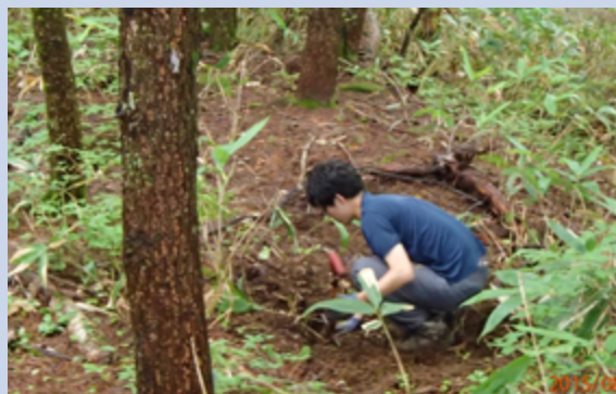
本白根山の山中に観測機材を設置している様子。
