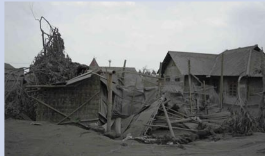
火山灰の積もった屋根に雨が降り、重みに耐え切れずに倒壊した一般家屋。
